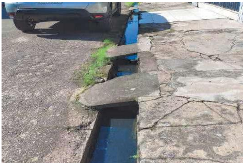
Figura 5 - Imagem do sistema de drenagem de água pluvial do município de Cametá, PA.
