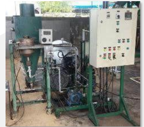
Skid de combustão
